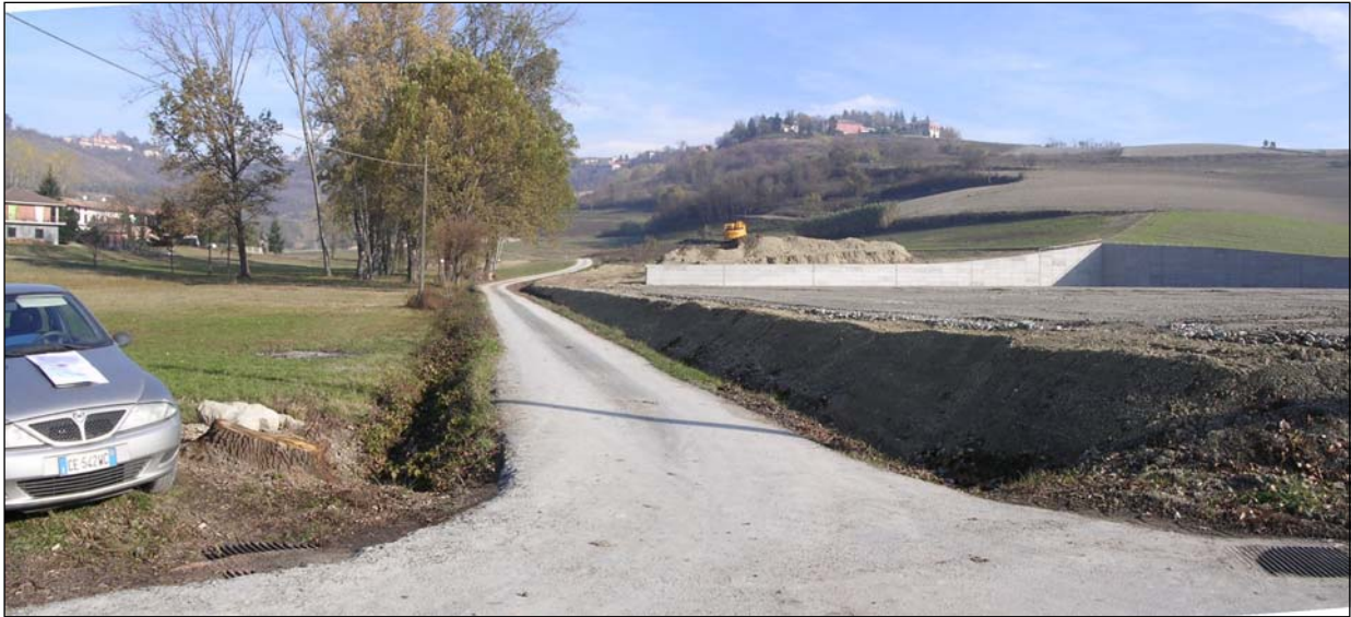
Foto 3: Panoramica verso monte dello sbocco del Rio del Vallone, in prossimità di Cavallo Grigio. Rilevato sul lato sinistro della strada.
